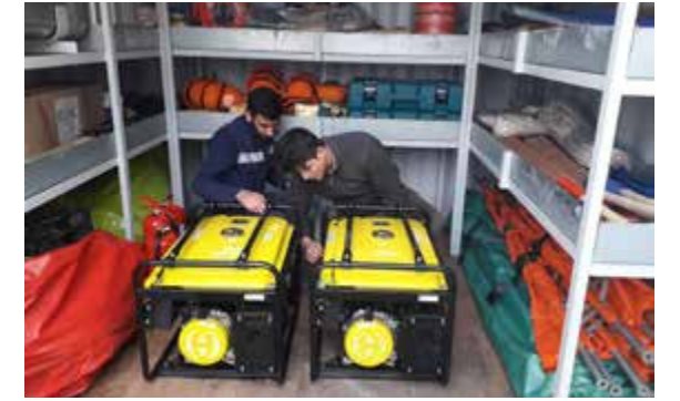
AFİS konteynerlerinin içerisindeki jeneratörlerin 3 aylık bakımları düzenli olarak gerçekleştirilmiştir.
